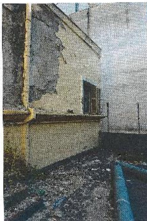
Φωτ.64: Φθορές από υγρασία στη δυτική όψη
