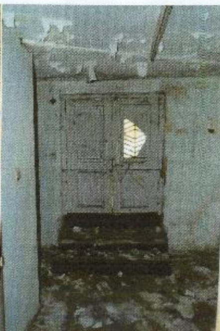
Φωτ.59: Φθορές εξαιτίας της υγρασίας στα υπάγειο
