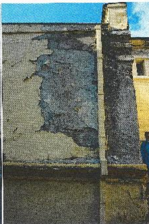
Φωτ.65: Φθορές από υγρασία στη δυτική όψη
