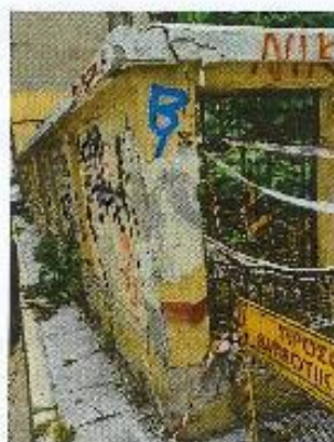
Φωτ.70: Ρηγμάτωση, φθορές και πλήρης αποκόλληση των επιχρισμάτων στην περιφράξη
