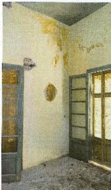
Φωτ.58: Εκτεταμένη υγρασία στην εσωτερική πλευρά τοίχων του αρόφου
