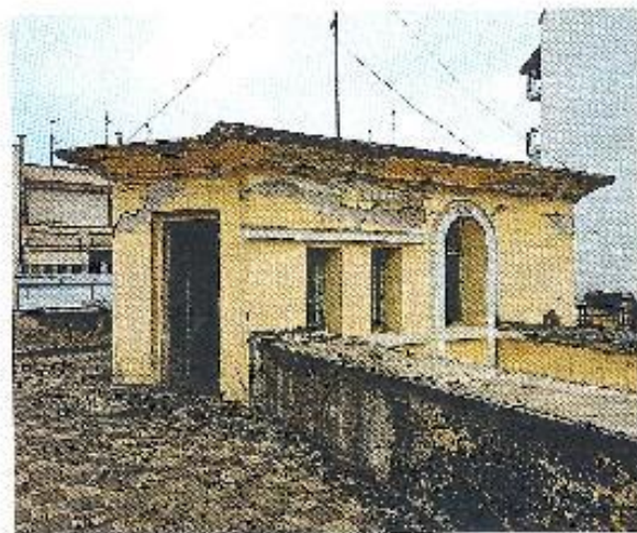
Φωτ.71: Υγρασίες στο δώμα και στα κουφώματα
