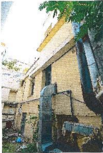
Φωτ.42: Αεριογωγός επί της νότιας όψης
