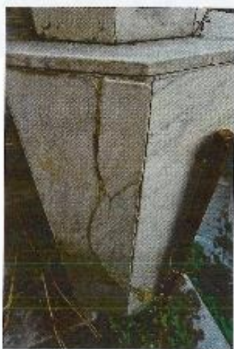
Φωτ.67: Φθορές σε μαρμαρίνη επένδυση
