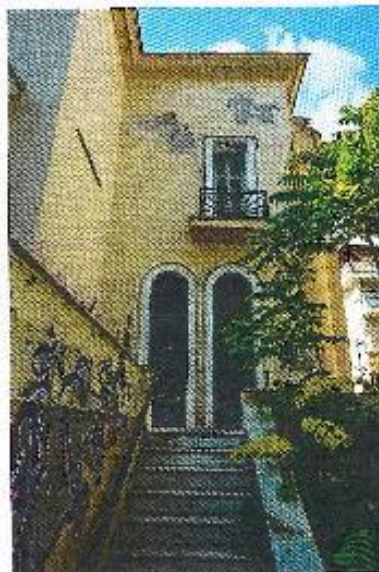
Φωτ.63: Αποκολλήσεις επιχρωμάτων και υγρασίες στη νότια όψη . Graffiti στα στηθία
