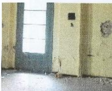
Φωτ.60: Φθορές από υγρασία στην εσωτερική πλευρά τοίχων του ισόγειου
