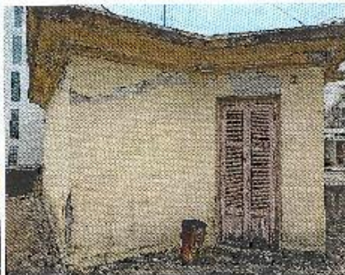
Φωτ.72: Υγρασίες στο δώμα και στα κουφώματα
