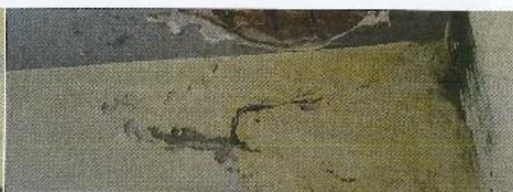
Φωτ.61: Φθορές από υγρασία σε τοιχοποιίες και οροφή αρόφου.
