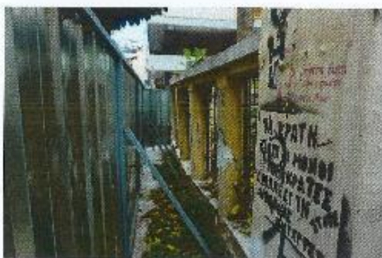
Φωτ.69: Απόκλιση από την κατακόρυφο στην περιφράξη
