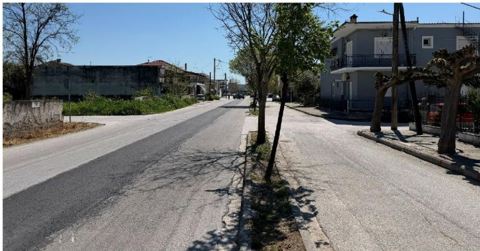
Κατεστραμμένα πεζοδρόμια χωρίς κράσπεδα που καταλαμβάνονται από βλάστηση
